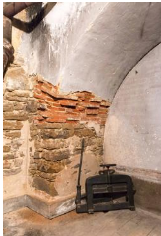
Une partie de la voûte qui va être dégagée et mise en valeur lors des futurs travaux.
